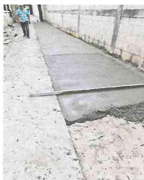
Losa de patio en la entrada principal
